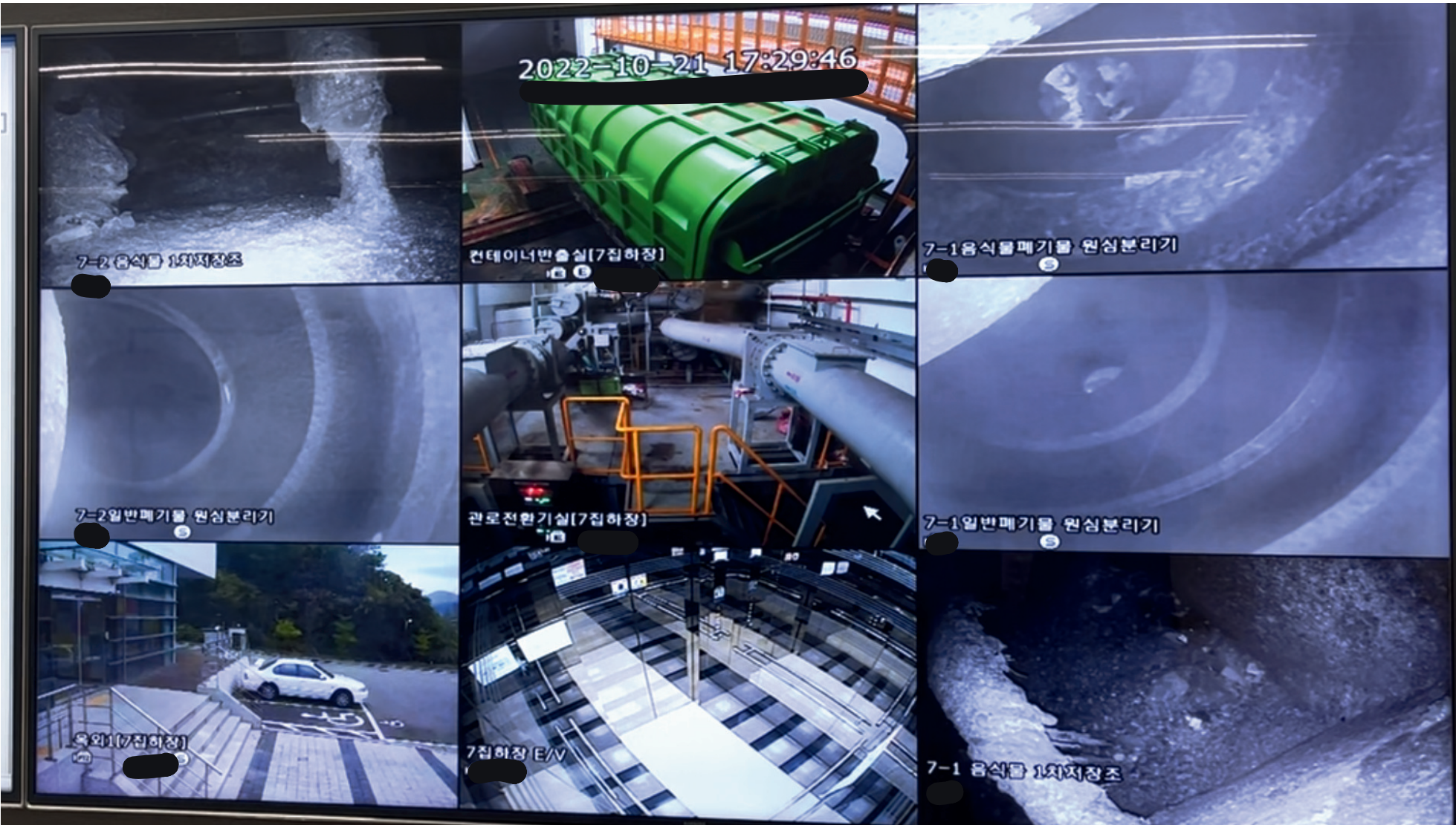
그림4 집하장 중앙제어실 모니터링 스크린 도식 (출처: 본인 촬영)
